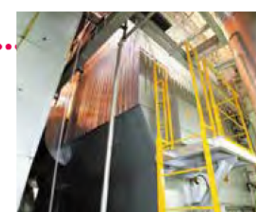
ろ過式集じん器 排ガスの中の細かな灰をとります。
