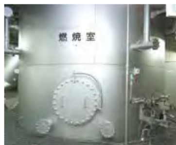
燃焼室 ガスを高い温度で燃やし、 ダイオキシンがでないようにします。
