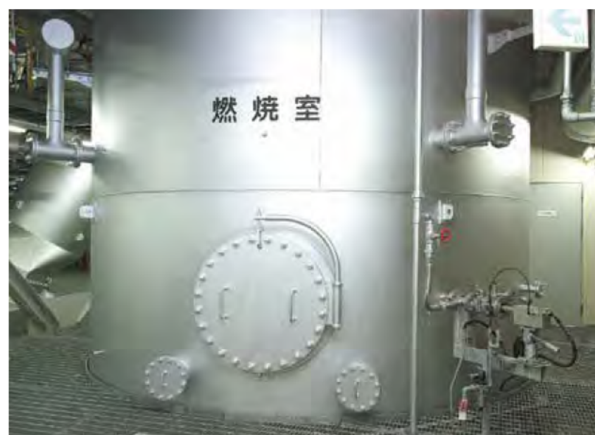
■燃焼室 溶融炉より発生した熱分解ガスを完全燃焼する独立した燃焼室です。
