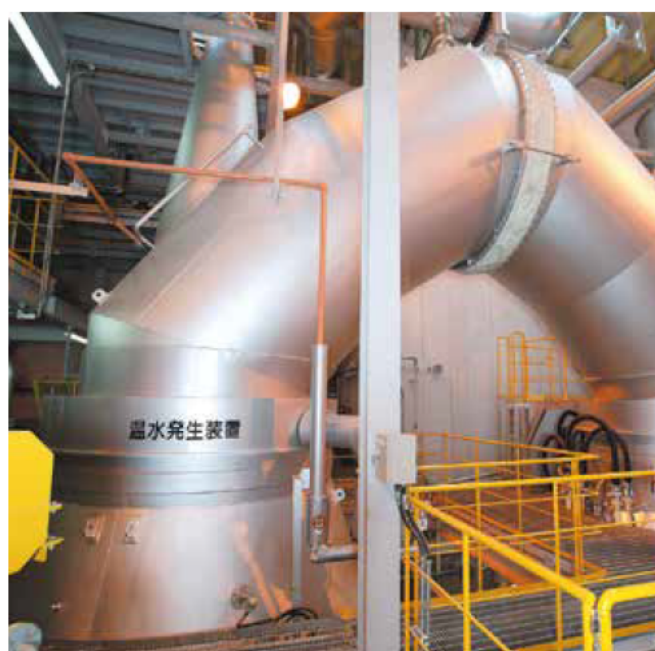
■温水発生装置 余熱利用に必要な温水をつくります。
