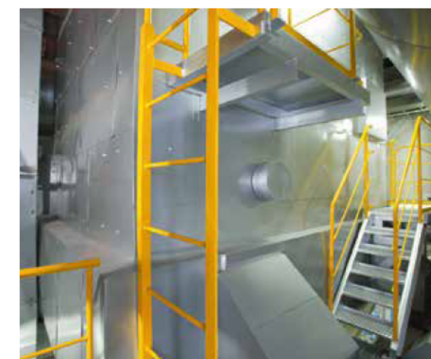
■触媒反応塔 触媒により、ダイオキシン類や窒素酸化物を分解し、無害化します。
